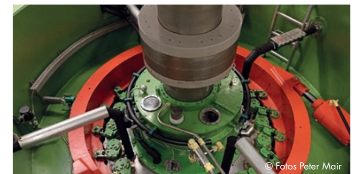
▲ Eine der beiden Francis-Turbinen im KW Amlach.
