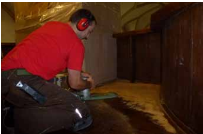
Seppi Tiefnig schleift den Boden der Empore ab und ölt ihn ein.
