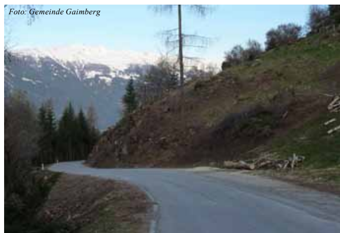
Aufgrund intensiver Niederschläge mussten Teile der Straßenböschung auf der Faschingalmstraße saniert werden.
