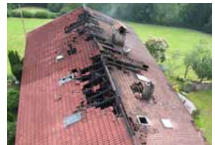
Teile des Dachstuhles des Gebäudes wurden beim Brand auch zerstört.
