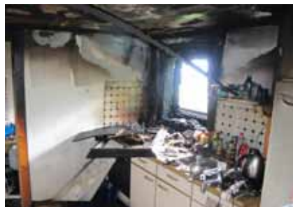
Der Wohnhausbrand brach in der Küche im Obergeschoß aus.
