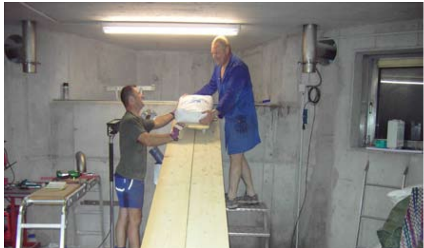
Norbert Duregger und Siegfried Thaler beim Fertigstellen der Entsäuerungsanlage
